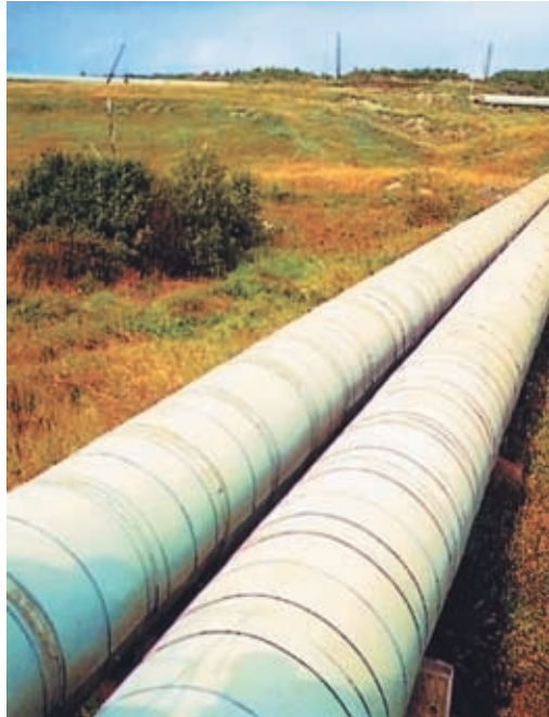
Рис. 4.44. Трубопровод, изолированный хризотилцементными теплоизоляционными скорлупами
