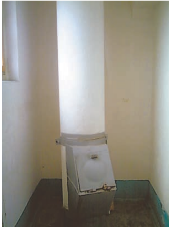
Рис. 4.36. Ствол мусоропровода из хризотилцементных труб
